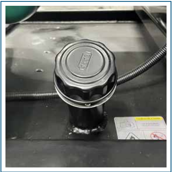
Carga de combustible
