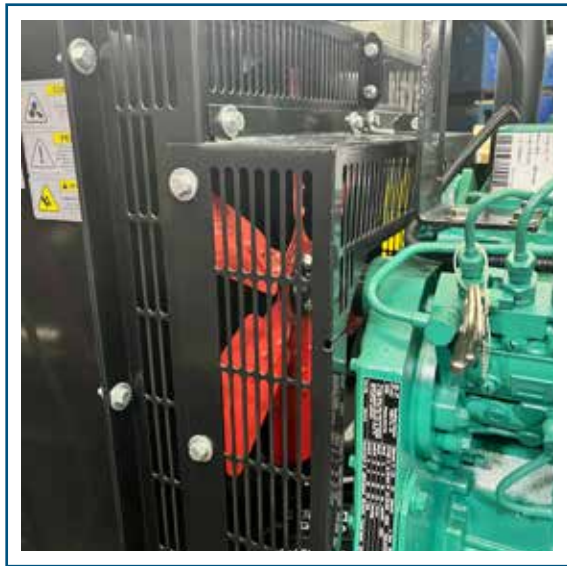
Refrigeración por agua
